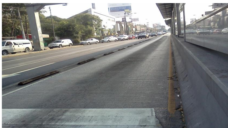
Ilustración 81 Carril exclusivo sistema Metrobús mediante delimitadores
