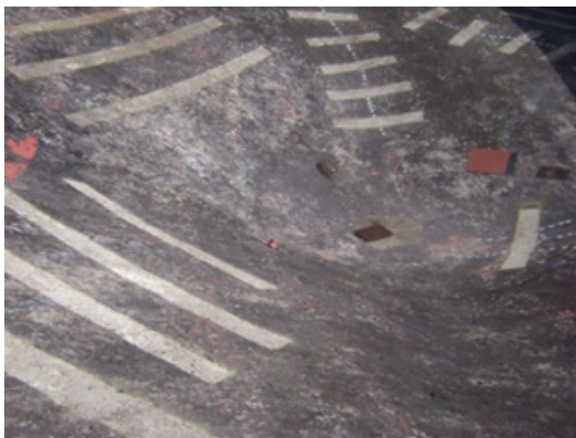
Fig. 96 Detalle del impermeabilizante en azotea de las cubiertas, 2009. Fotografía: Antonio Espinoza
