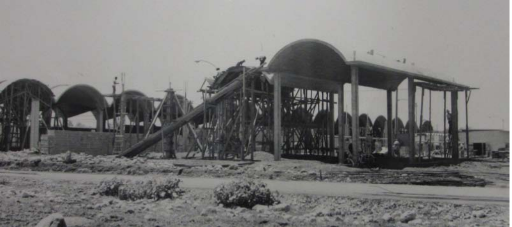
Fig. 55 Proceso constructivo de las cubiertas en cuarto de máquinas y nave principal. Archivo Max Cetto, UAM-A
