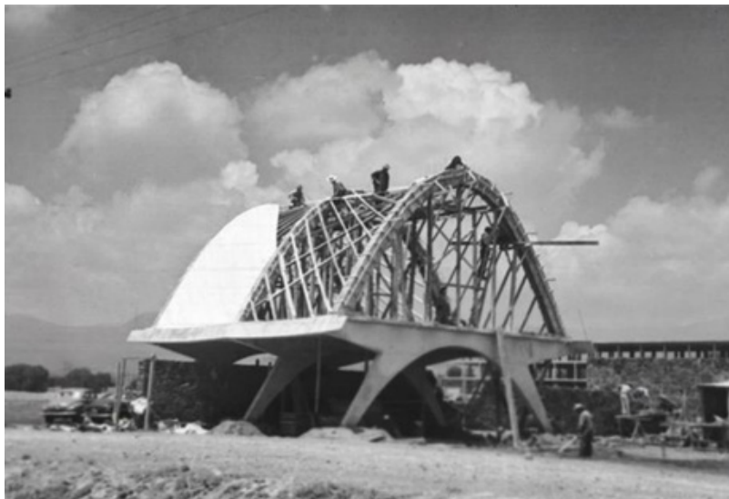
Fig. 16 Pabellón de rayos cósmicos en construcción. Jorge González Reyna, Félix Candela. Ciudad Universitaria (1952)
