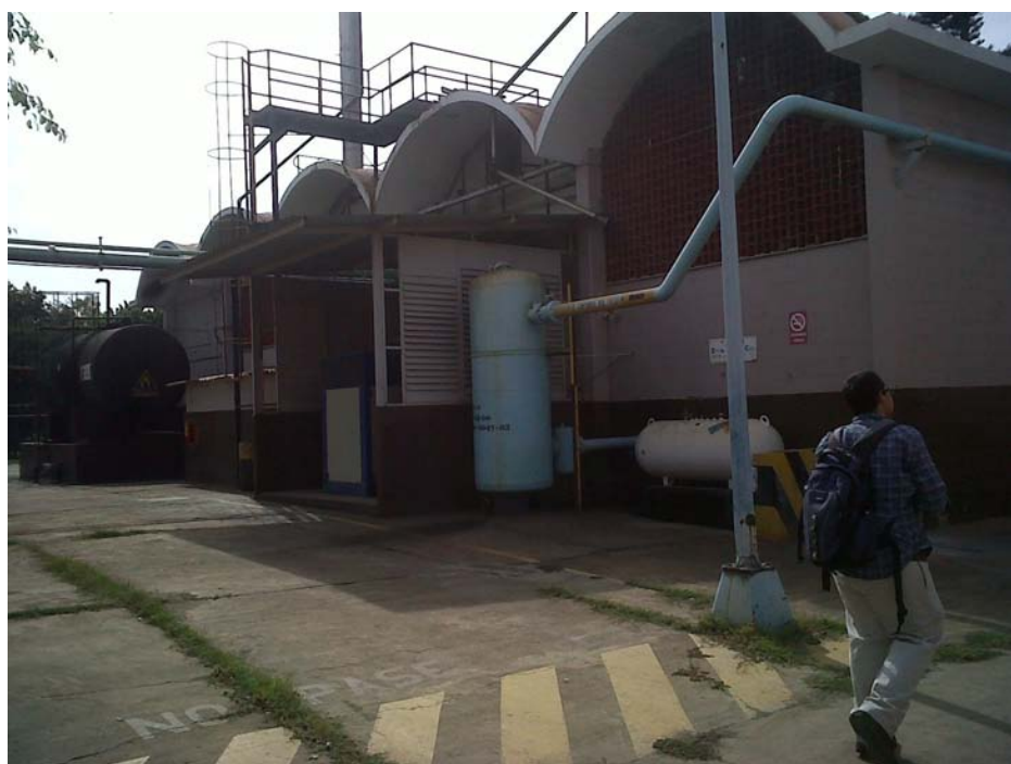
Fig. 87 Estado actual del interior de la fachada del cuarto de máquinas (2012). Fotografía: Luis Manuel Chacón
