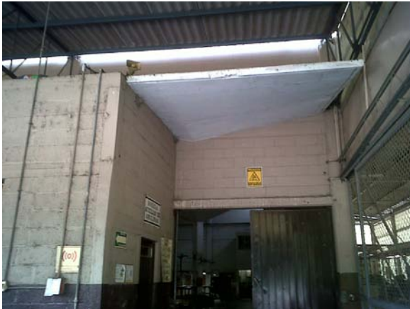
Fig. 92 Estado actual del acceso al área de bodegas, modificada, 2012. Fotografía Luis Manuel Chacón
