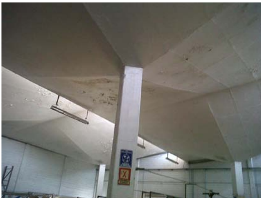
Fig. 94 Detalle de los daños a causa de la humedad en los paraguas de las bodegas, 2012. Fotografía: Luis Manuel Chacón
