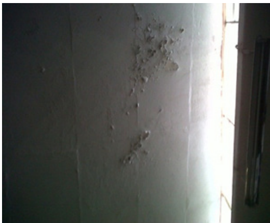
Fig. 95 Detalle de los daños a causa de la humedad, desprendimiento de pintura vinílica, 2012. Fotografía: Luis Manuel Chacón
