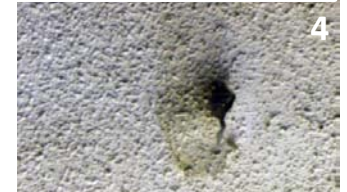
Gráfico No. 66. Plafón dañado.
