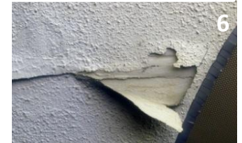
Gráfico No. 68. Plafón dañado.
