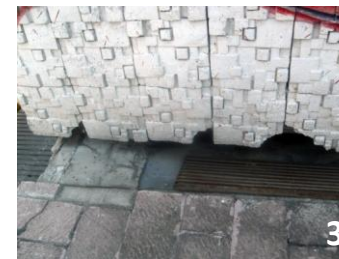
Gráfico No. 76. Daño en fachada.
