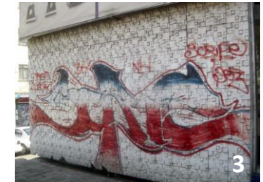
Gráfico No. 77. Daño en fachada.
