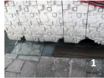
Gráfico No. 71. Daño en fachada.
