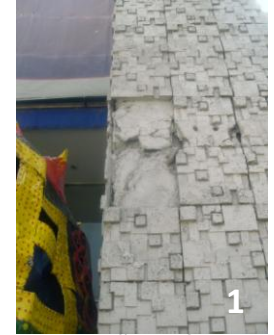
Gráfico No. 72. Daño en fachada.
