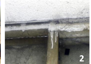
Gráfico No. 57. Losa dañada.
