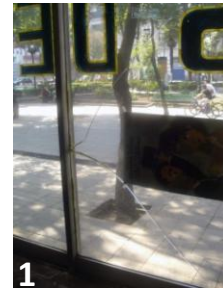
Gráfico No. 58. Cancelería dañada.
