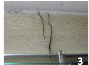
Gráfico No. 60. Trabe dañada.
