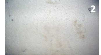
Gráfico No. 64. Plafón dañado.
