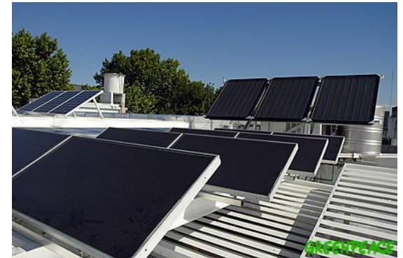
Gráfico No. 92. Paneles solares.
