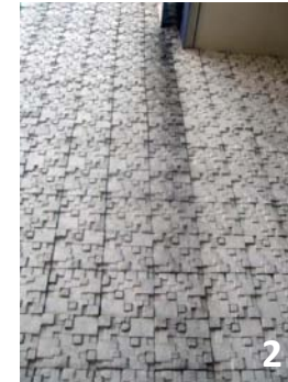
Gráfico No. 73. Daño en fachada.
