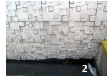
Gráfico No. 74. Daño en fachada.
