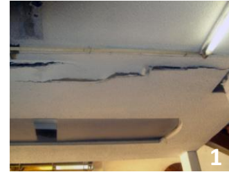
Gráfico No. 56. Plafón dañado.
