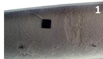
Gráfico No. 63. Plafón dañado.
