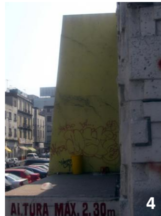
Gráfico No. 75. Daño en fachada.
