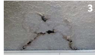
Gráfico No. 65. Plafón dañado.
