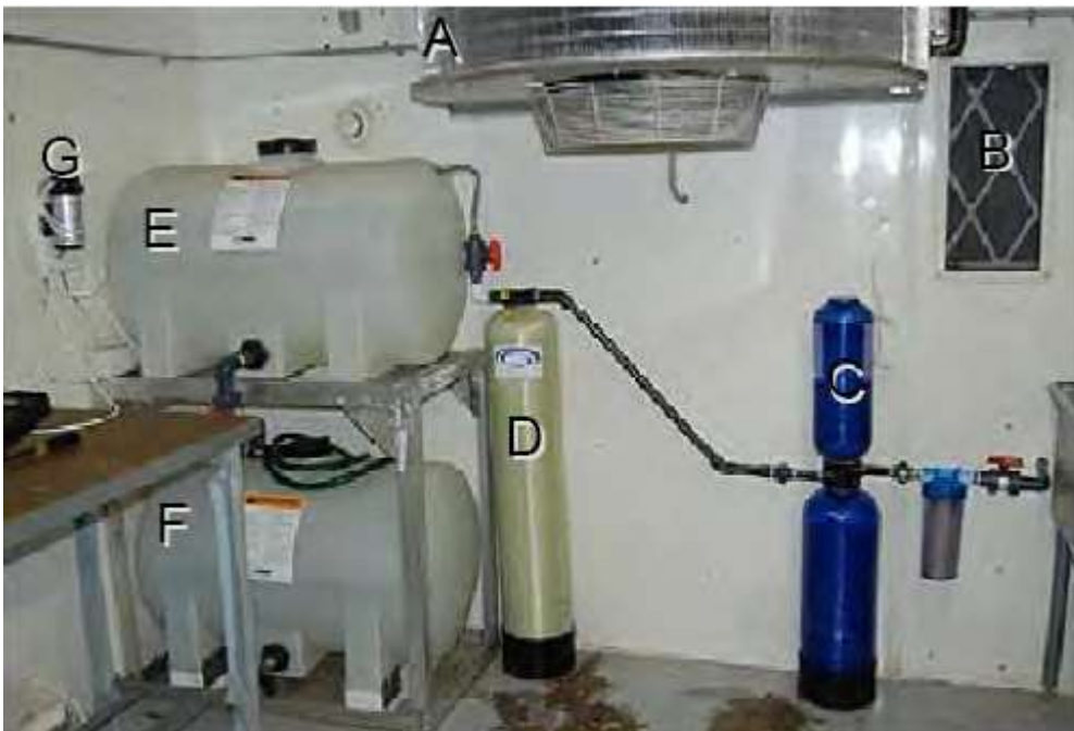
Figura 19. Sistema de filtración de agua para sapos de Kihansi en el Zoológico del Bronx. A) Unidad de manejo del aire; B) Filtro de aire colocado en la ventana de toma del cuarto; C) Pre-filtro y filtro de carbón; D) Filtro de Arsenico/fosfato elaborado por BASF y distribuido por Aquasana en Houston, Texas; E) Reservorio de agua filtrada; F) Recipiente de reconstitución donde se añaden sales y minerales al agua de OR; G) Rociador ProMist® que asperja cada exhibidor del cuarto. La entrada a este cuarto está equipada con una pediluvia lleno con desinfectante Virkon-S®. Fuente: Association of zoos & Aquarium en 2008
