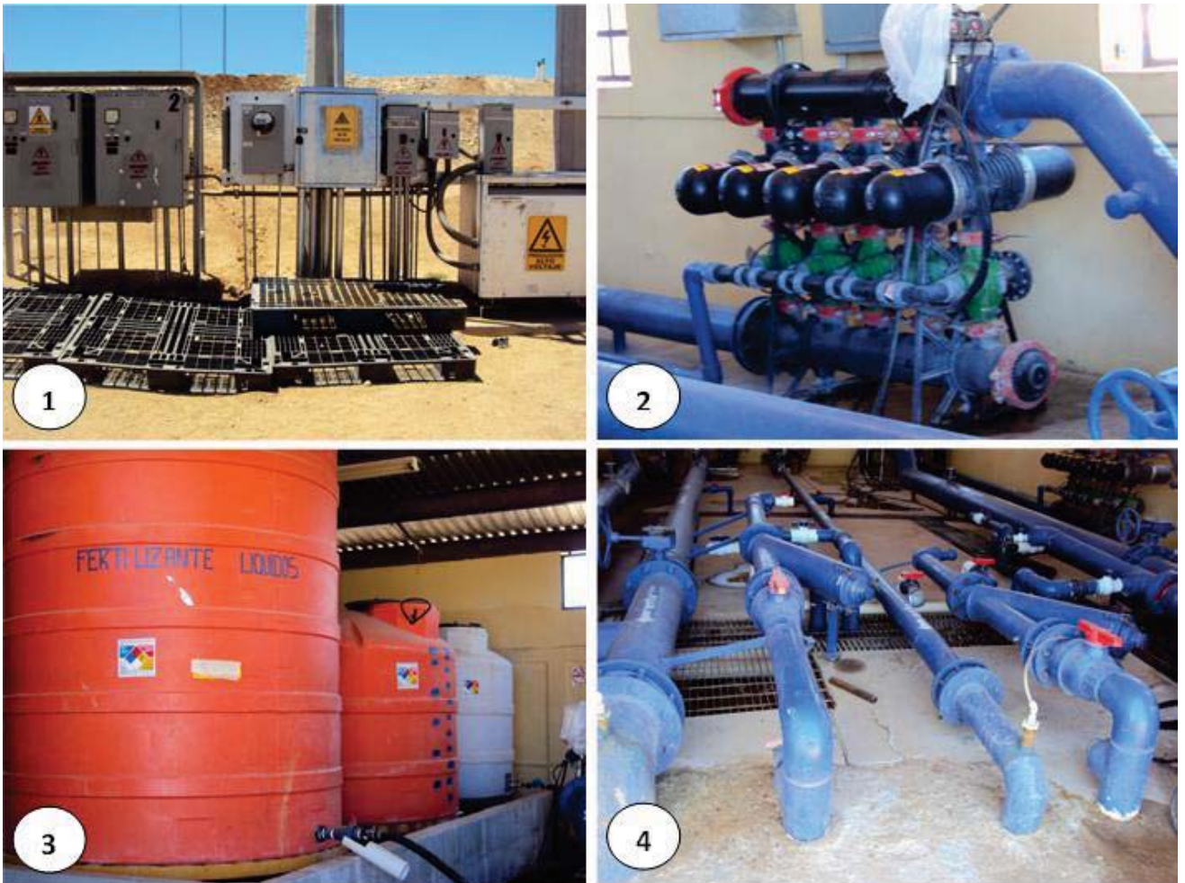
Fig. 14. Instalaciones y componentes del sistema de riego: 1) Sistema de control de encendido y apagado de sectores, 2) Filtros, 3) Tanques de fertilizantes líquidos, 4) Tubería y válvulas de control 1
