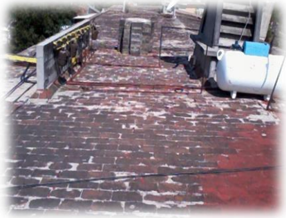
ILUSTRACIÓN 4. ESTADO ACTUAL DE LAS AZOTEAS DE LA UNIDAD.
