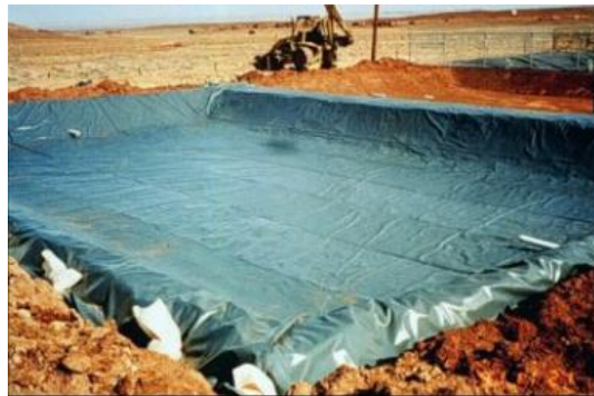
ILUSTRACIÓN 16. EL SITIO DE LA CONSTRUCCIÓN QUE MUESTRA UN RECUBRIMIENTO PLÁSTICO SINTÉTICO PARA HUMEDALES (PURDUE2007).
