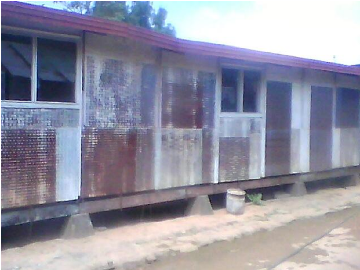
En estas condiciones se encontraba la "Casa Blanca" antes de su remodelación en 2013. Fotografía tomada por Jorge R. Bas Lavallo
