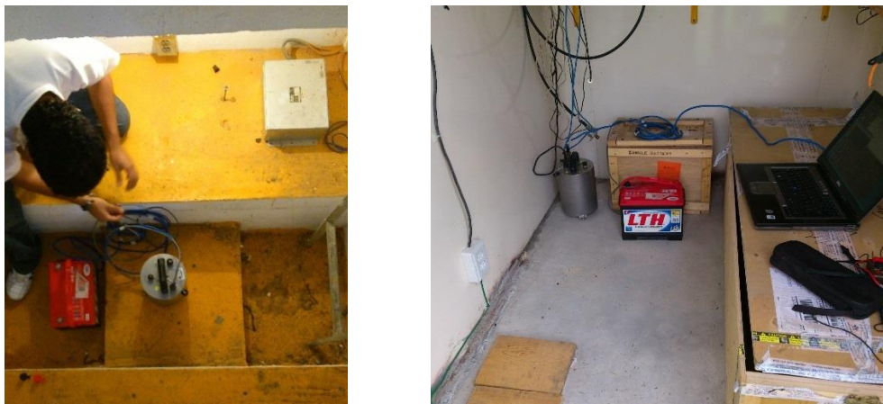
Figura 2.14 Colocación de un sismógrafo de banda ancha en las casetas de las estaciones acelerográficas CUIP (izquierda) y CENA (derecha) para el registro de ruido ambiental
