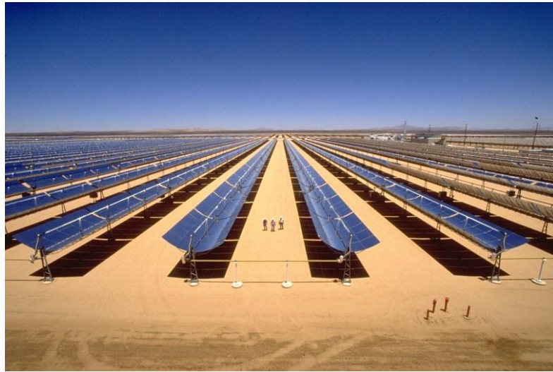
Figura 1.4. Sistemas de concentración de reflexión. Tipo canal parabólico.(complejo de plantas SEGS en el desierto de Mojave, California, USA)
