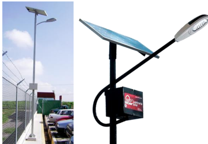
FIG.46 Y 47. Generación de energía eléctrica por energía solar. Autor: Solarlux iluminación
