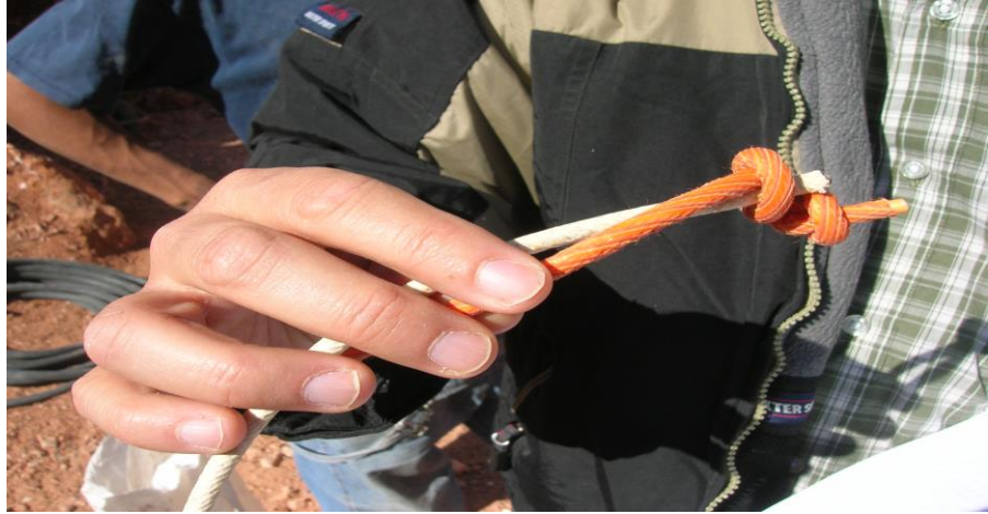
Figura 64.- Cañuela y primacord utilizadas en la voladura en la mina El Redentor, comunidad de La Trinidad, San Juan de Rio, Querétaro, México.
