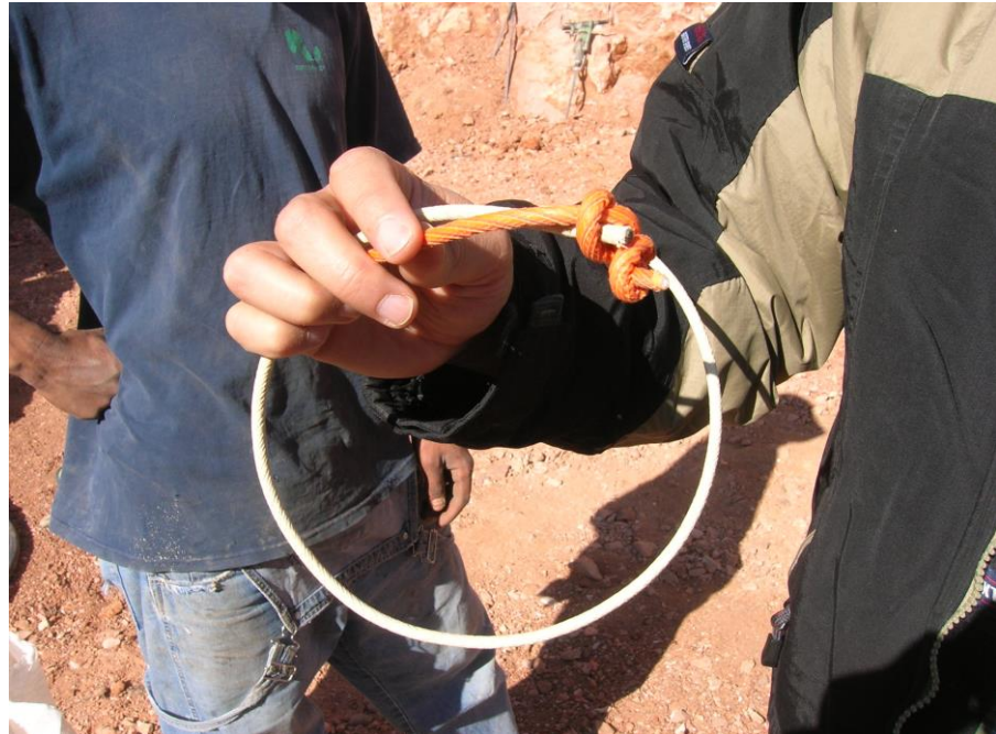
Figura 63.- Cañuela y primacord utilizadas en la voladura en la mina El Redentor, comunidad de La Trinidad, San Juan de Rio, Querétaro, México.
