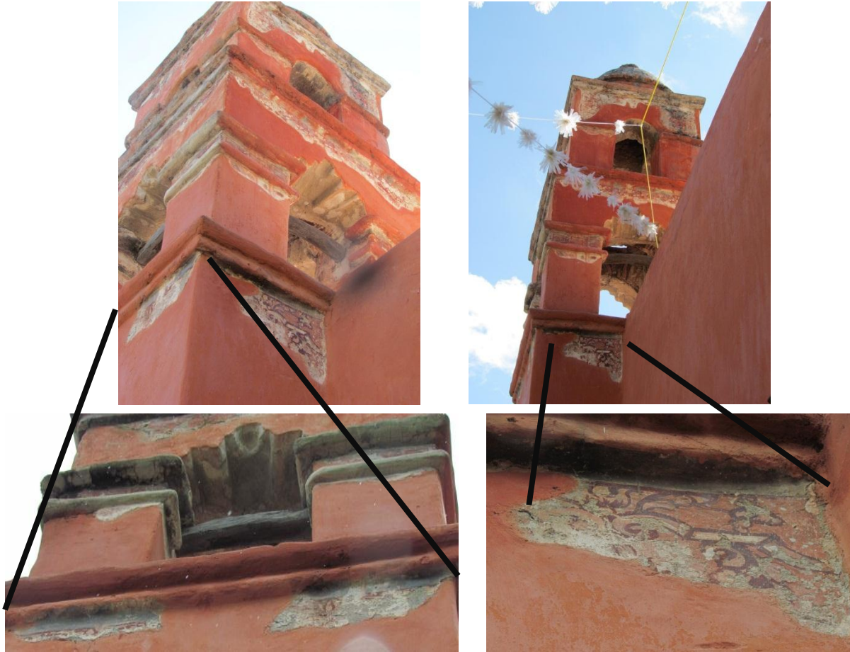
Imagen 11. Detalle de la cúpula donde se conserva enlucido pictórico original. Capilla La Pinta, San Miguel Ixtla. Foto BIPP.
