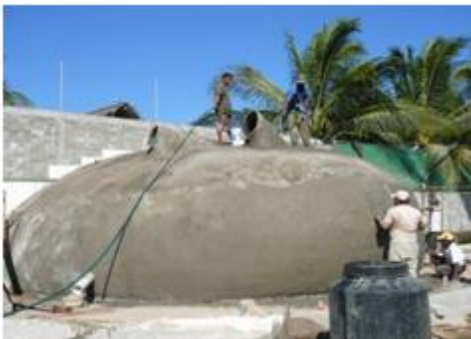
Imagen 23. Ejemplo del proceso de construcción en ferrocemento, la obra se edificó en Acapulco Diamante, Guerrero. Armado de varillas de 3/8" @20cm por ambos lados.
