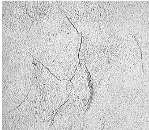
Imagen 3. Fisuración por retracción plástica
