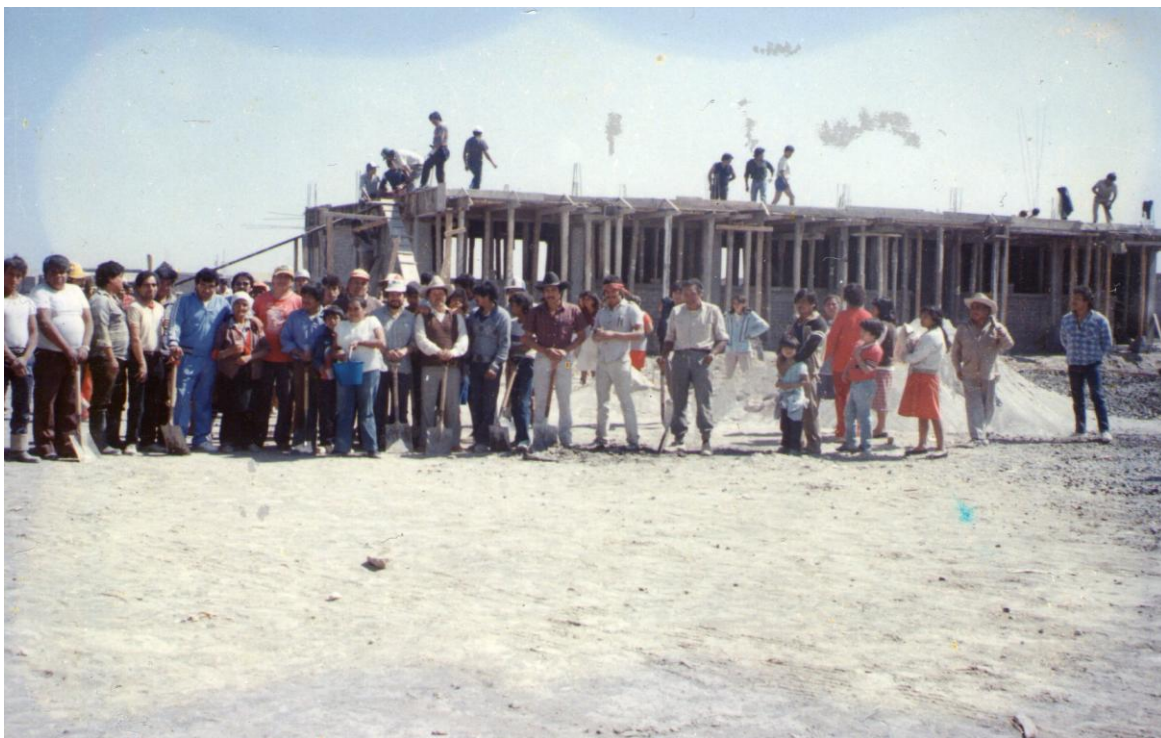
Foto tomada en mayo de 1989. Construcción de los primeros salones de concreto; muestra fehaciente de la participación de padres de familia, maestros y la organización social 165 .
