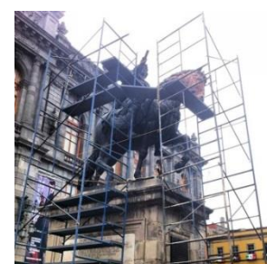
Escultura ecuestre de "El Caballito". Se observa el deterioro de la escultura, muestra de una intervención incorrecta.
