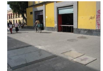
Imagen desde la calle 5 de Febrero, donde se puede observar la falta de integración en el diseño de los registros y el mal empleo en la regularidad superficial de los mismos.
