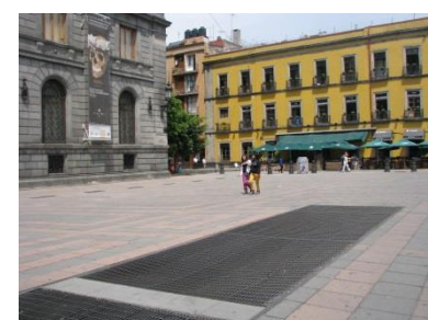
Falta de integración entre el diseño del pavimento y el empleo de registros.
