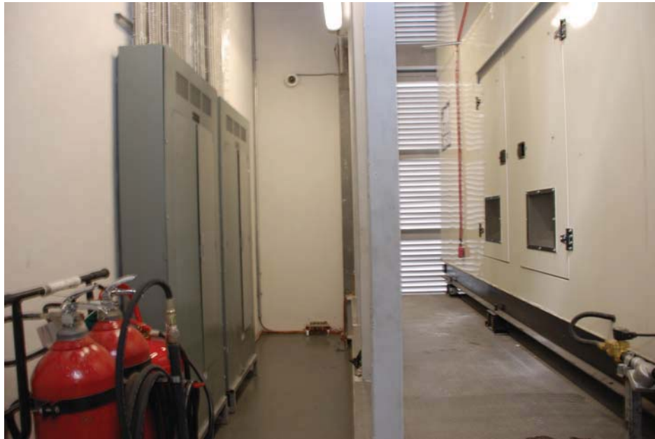
Fotografía 9 Vista de Planta de Emergencia y tableros eléctricos reutilizados para el proyecto de foros de Grabación
