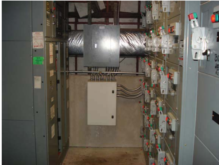
Fotografía 07 Vista de tableros eléctricos generales reutilizados para proyecto de Foros de Grabación
