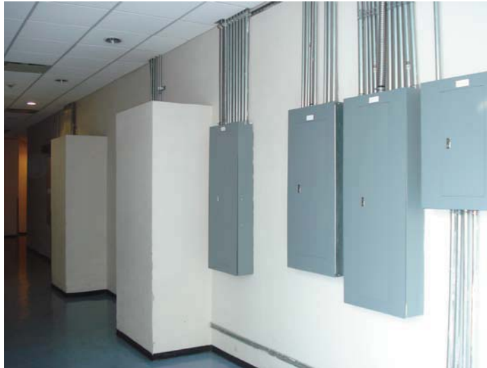
Fotografía 08 Vista de tableros eléctricos y de iluminación reutilizados para proyecto de Foros de Grabación
