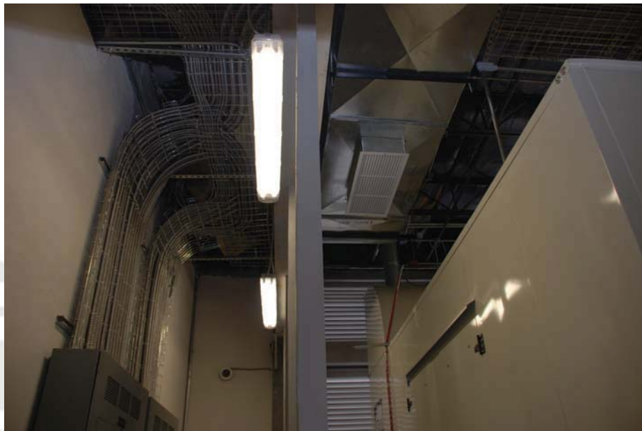
Fotografía 10 Vista de Planta de Emergencia, tableros eléctricos y canalizaciones reutilizados para el proyecto de foros de Grabación
