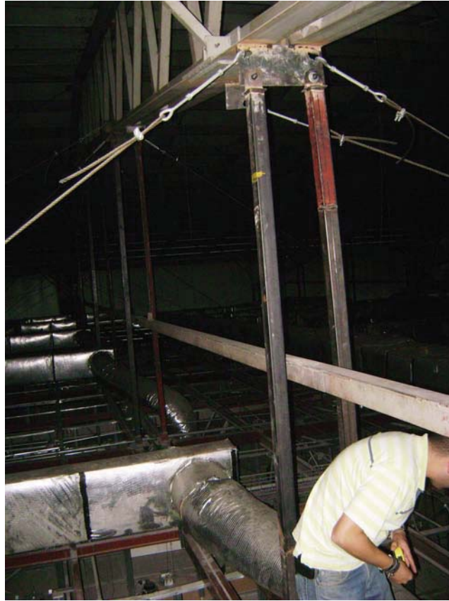
Fotografía 06 Vista de retícula metálica que soporta ductos de aire acondicionado
