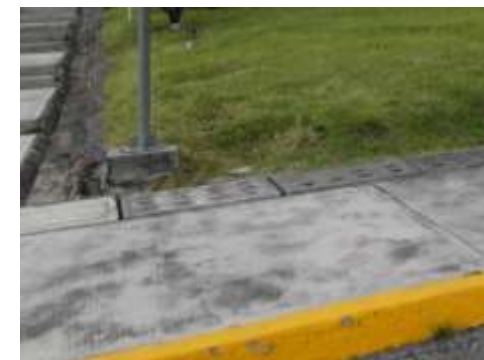
Imagen 21. Alcantarillado Aeropuerto de Colima. 2013.
