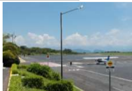
36 Imagen 24. Alumbrado Público Aeropuerto de Colima. 2013.
