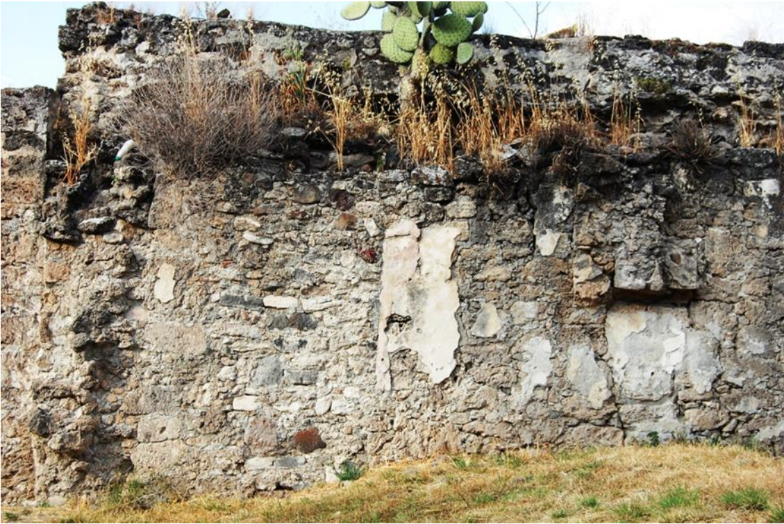
Fig. 27. Barda del atrio con huellas de desprendimientos. Segmento J (fig. 16). Del autor (2011).
