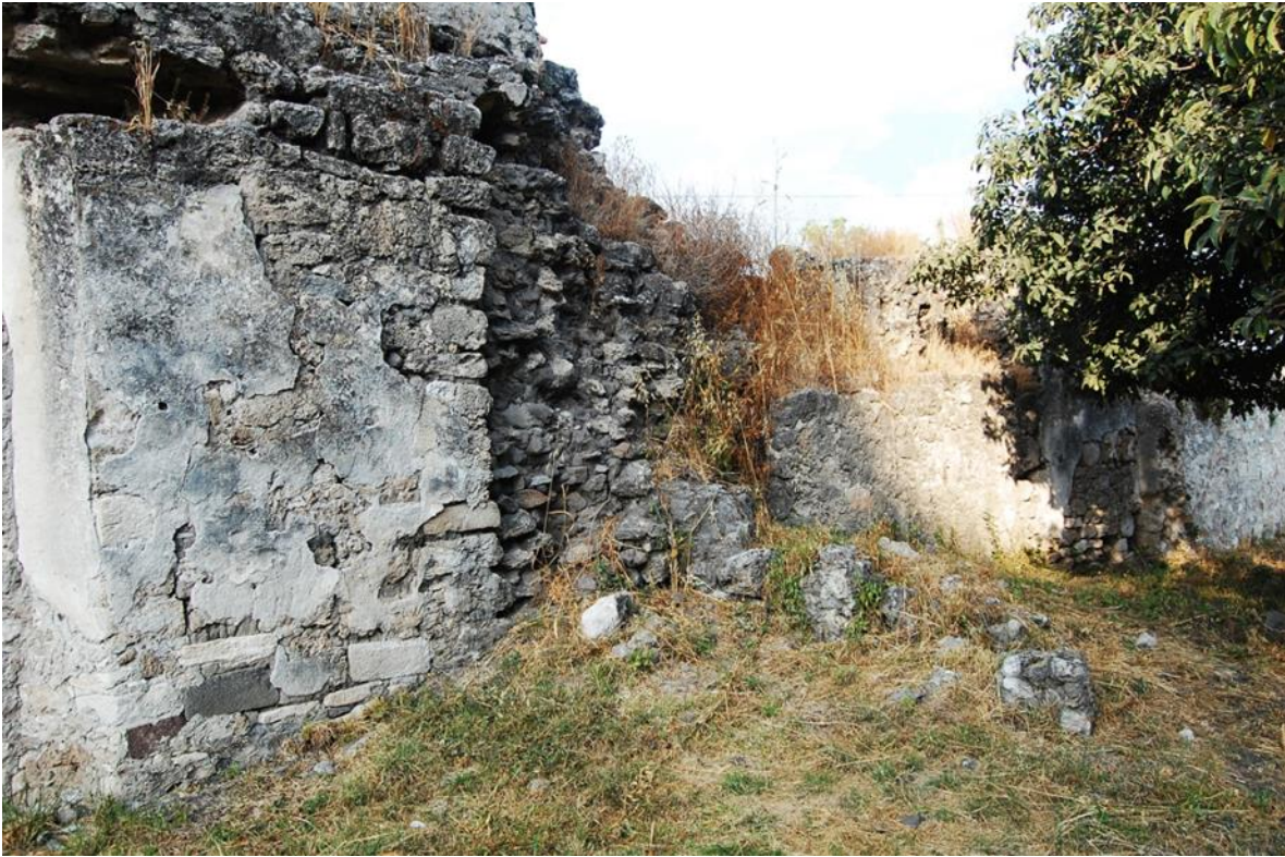
Fig. 30.1. Barda del atrio con desprendimientos. Segmento L (fig. 16). Del autor (2012).
