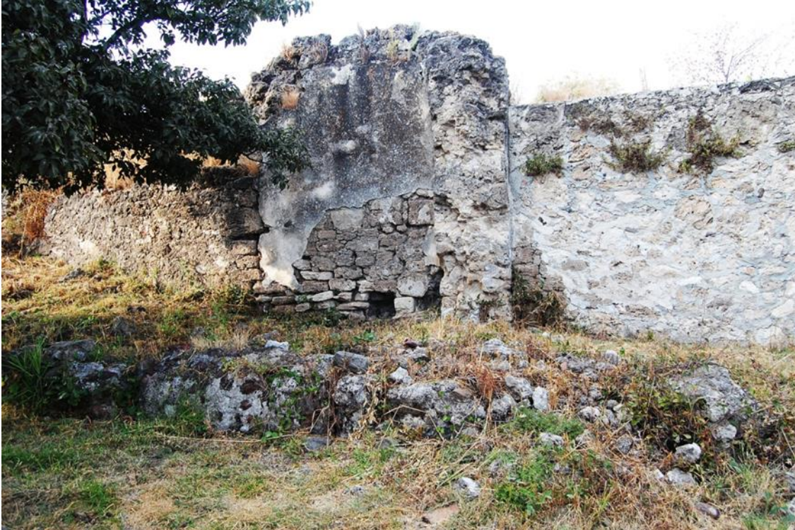
Fig. 30. Barda del atrio con desprendimientos. Segmento L (fig. 16). Del autor (2012).
