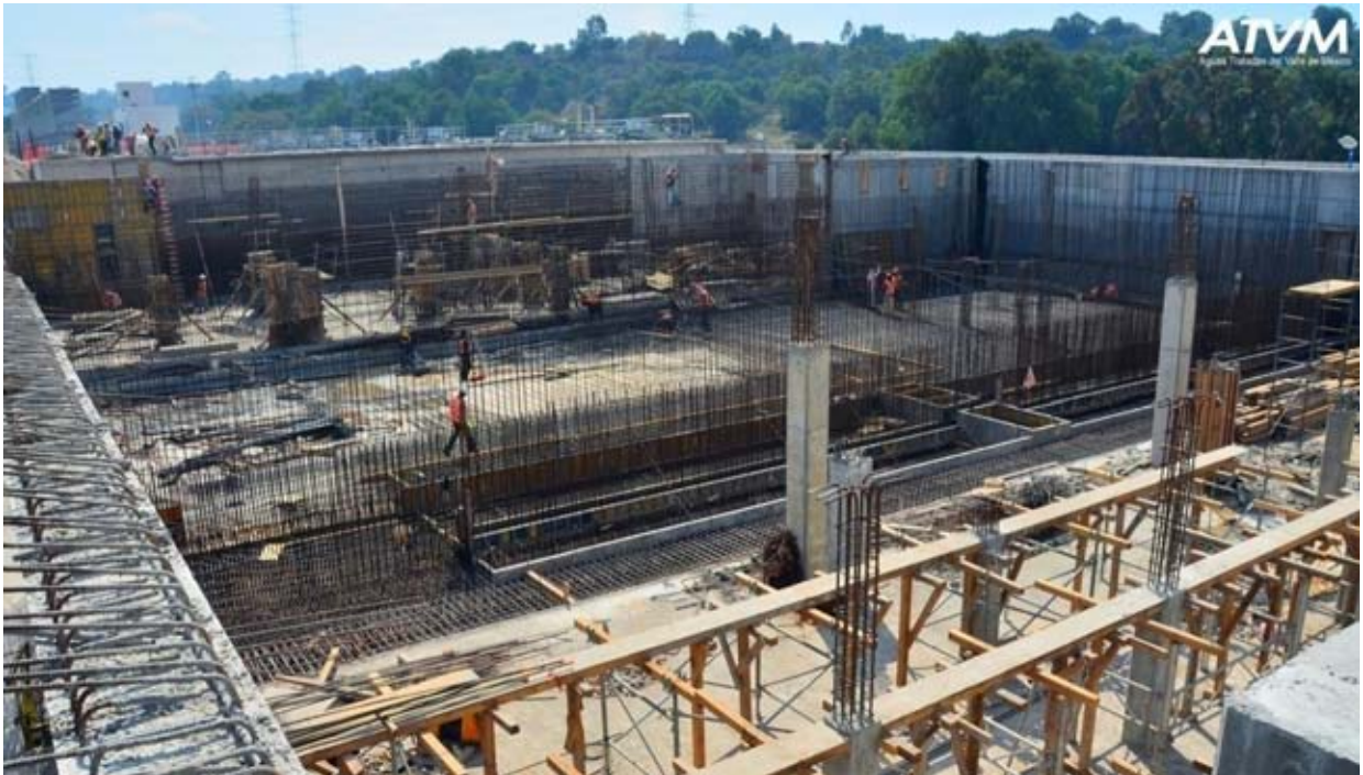
Tanque de concreto reforzado en la PTAR Atotonilco.
