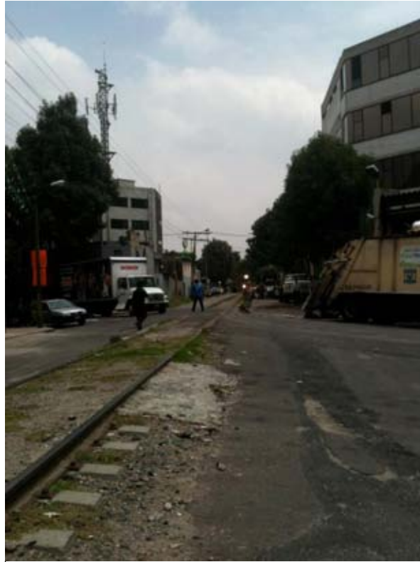
Fig.38 Estado anterior a la intervención Cruce FFCC de Cuernavaca y Lago Como
