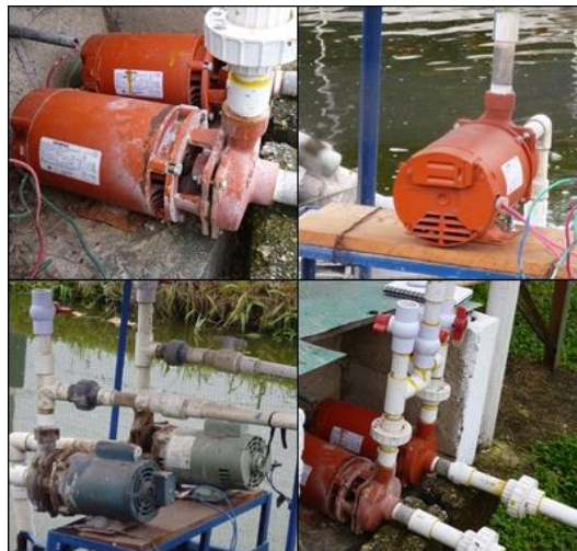
Figura 3.11 Fotografía de las bombas de agua utilizadas en el módulo de producción acuícola del CEIEGT, sus características eléctricas se detallan en la tabla 4.1
