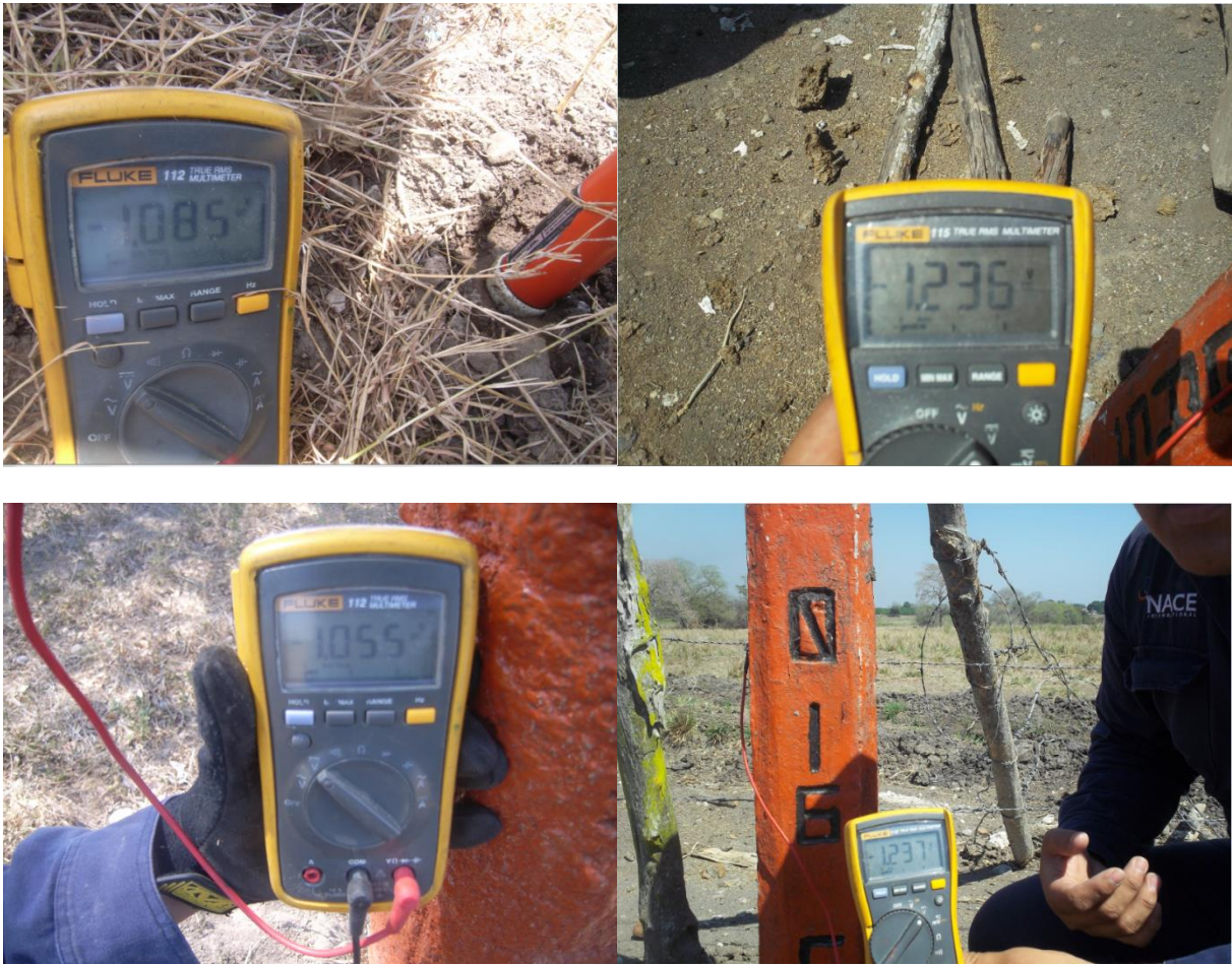
Figura 63 Resultados de campo caso ducto ánodos de sacrífico
