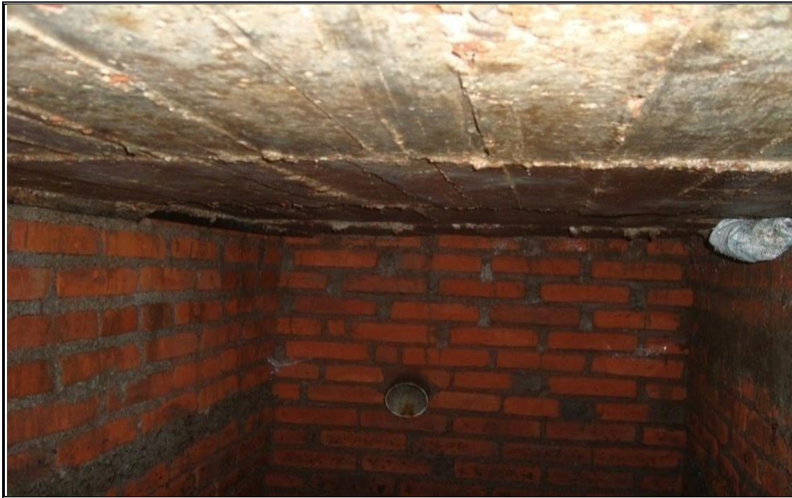
Figura 5.48 Fotografías de las paredes de la fosa séptica de la casa en estudio
