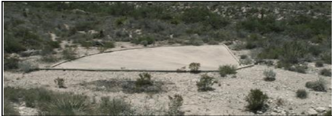
Figura 3.10 Ladera cubierta con concreto en forma de abanico (Hernández, 2009)
