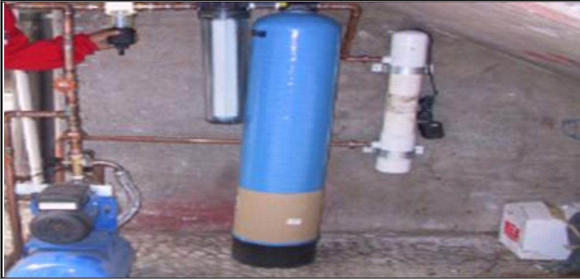
Figura 3.14 Instalación completa con filtros comerciales y sistema de bombeo (Adler y col., 2008)
