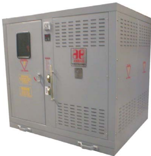
SUBESTACIÓN ÁMBAR PACK
