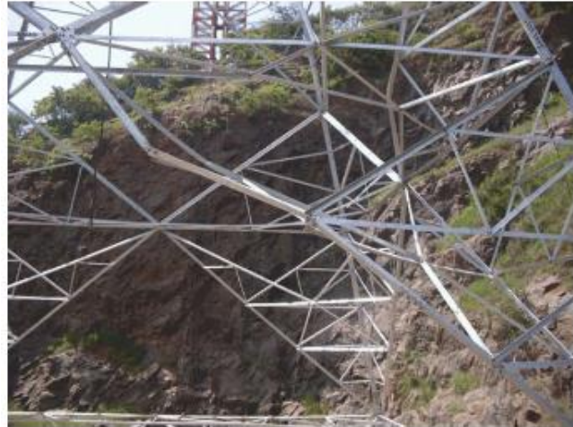
Figura 4.13 Falla por incorrecta diagonalización (Prasad Rao et al., 2010).
