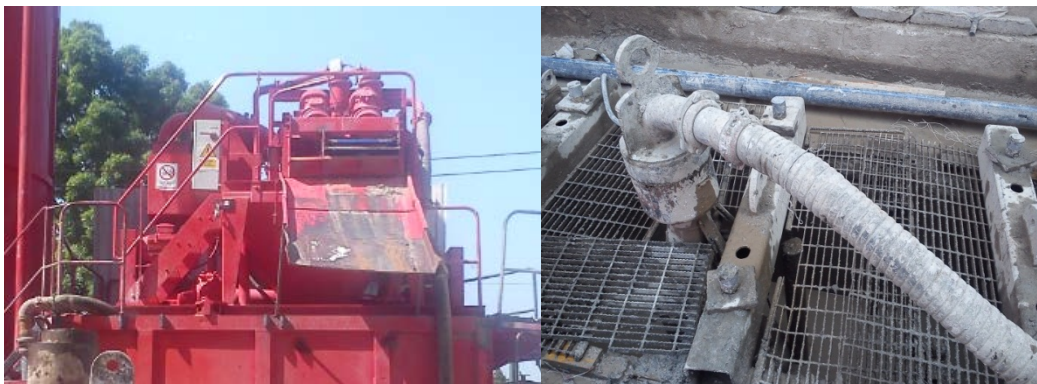
Fig. 4.x. Desarenador tipo Caviem y tubería para la extracción de lodo para su desarenado.
