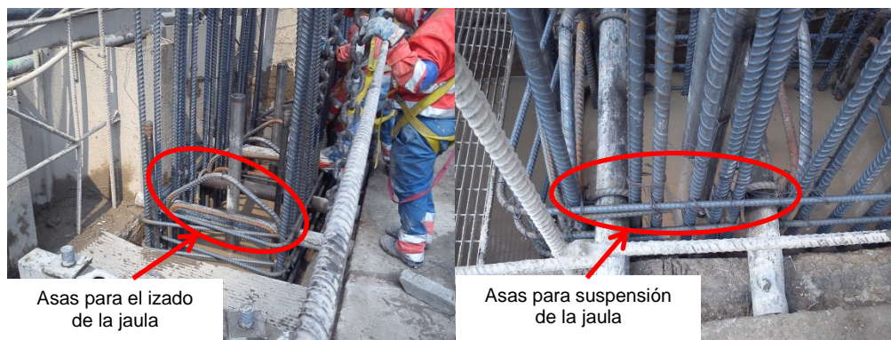
Fig. 4.I.1. Asas para el izado y sostén del armado durante la unión de jaulas y colado.
