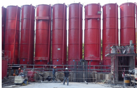
Fig. 4.u. Silos para almacenamiento de lodo bentonítico.
