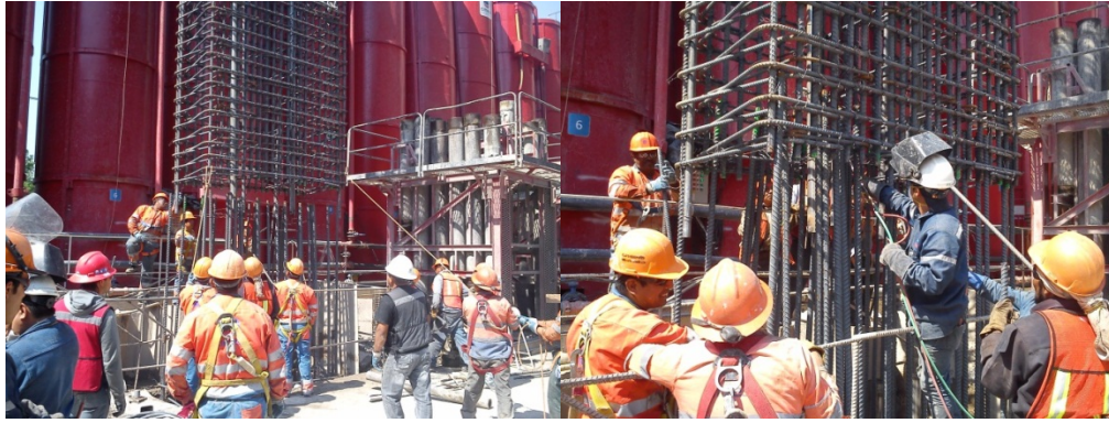
Fig. 4.m.1. Descenso de una sección de la jaula y traslape de acero longitudinal mediante soldadura. Referencia: Obra CIMESA, Reforma 509
