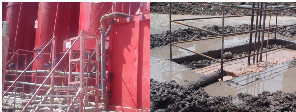
Fig. 4.v. Sistema de tuberías para el transporte del lodo bentonítico.
