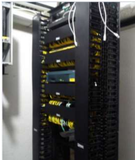
Figura 4.3 Acometida de cableado estructurado.
