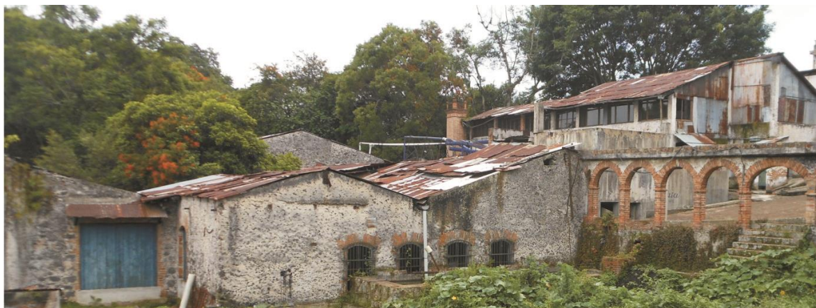
33. Fotografía del beneficio “La Mata” presenta cubiertas a dos aguas protegidas por láminas acanaladas de zinc, se observan principales deterioros en fábricas por falta de recubrimientos. Fuente: Ana Daría Torres.
