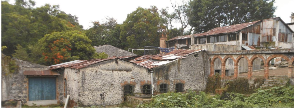
25. Beneficio “La Mata” presenta cubiertas a dos aguas protegidos por láminas acanaladas de zinc, se observan principales deterioros en fábricas por falta de recubrimientos. (Junio 2012) Fuente: Ana Daría Torres.
