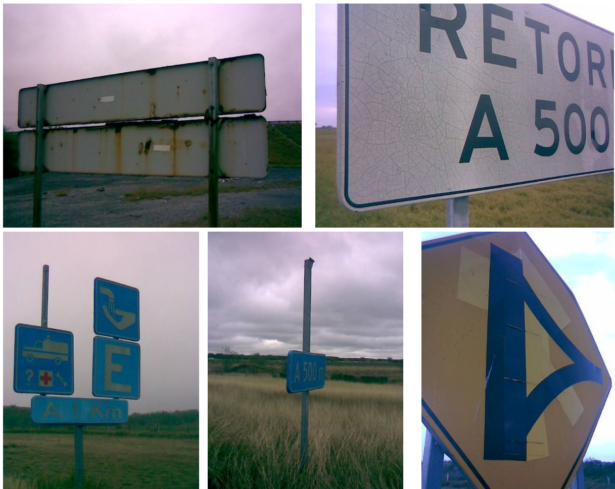
Figura V.3.4.1. Principales desperfectos en el señalamiento vertical
