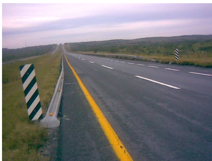
Figura IV.3.5.2. Ejemplo de Barrera de orilla de corona y secciones extremas en carretera.
