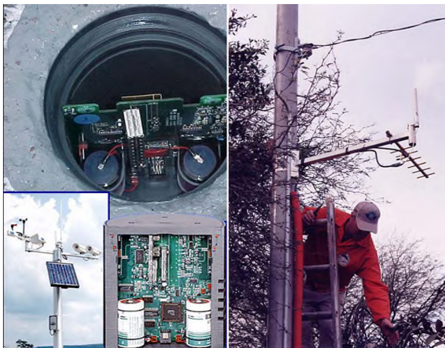
Figura II.5.1.1.1. Instalación de los diferentes equipos que conforman a una estación maestra.
