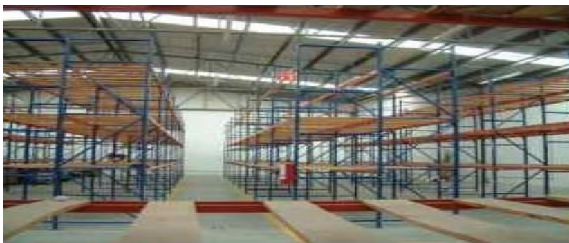
Fig. 14 Racks en piso de ventas
