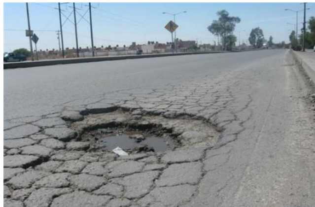
Figura. 3.9 Bache producido por el agrietamiento por fatiga (Carretera Libre Tepic- Guadalajara Km. 16+200, 2012)
