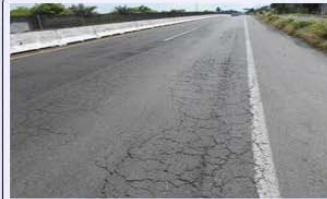
Se observa las grietas longitudinales y de piel de cocodrilo en la superficie de la carpeta asfáltica
