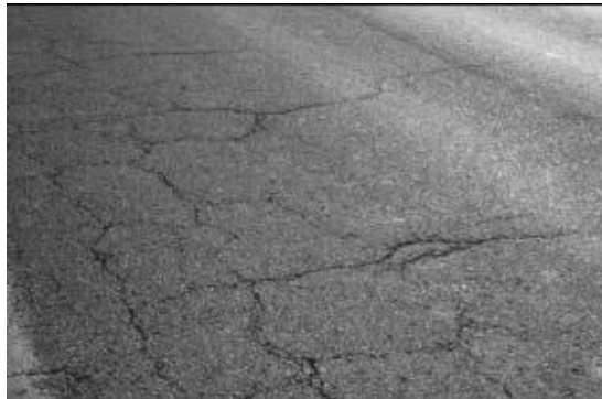
Figura 3.8 Agrietamiento en bloque (Fuente: Apuntes de ingeniería de pavimentos Ing. Fernando Sánchez Sabogal. 2012)
