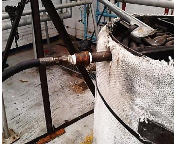
Figura 21. Llenado del serpentín previo a la prueba hidrostática.
