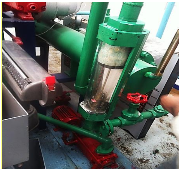
Figura 31. Instalación del rotámetro.
