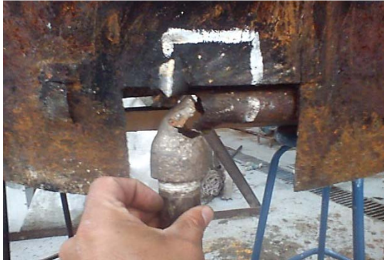
Figura 8. Salida de vapor corroída.
