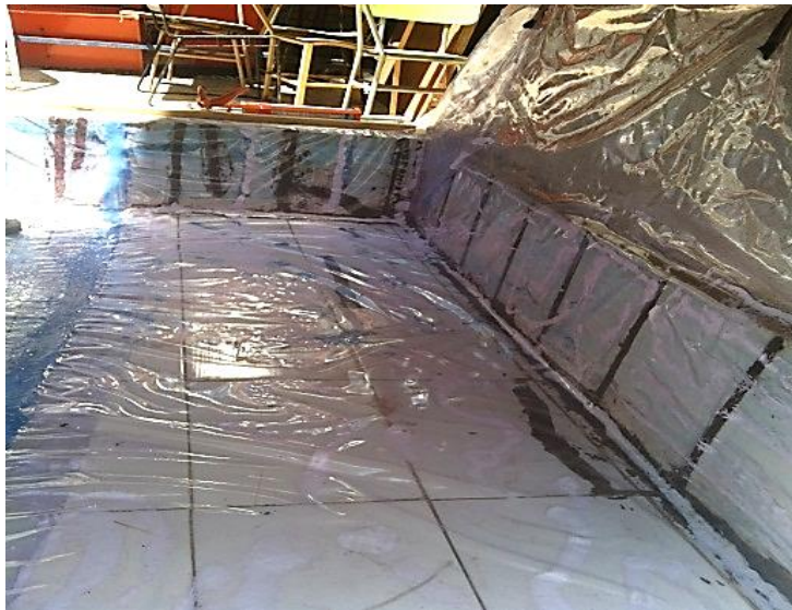
Figura 35. Forrado de la tina de la torre de enfriamiento.
