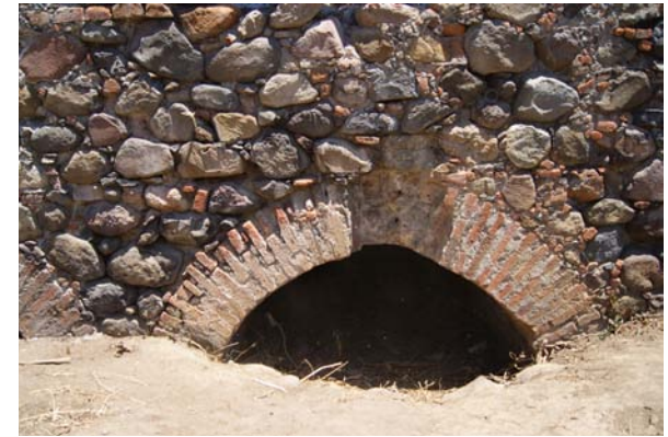
Fotografía 2 Detalle del cárcavo en el edificio de mollienda de trigo de la ex hacienda de Chicomocelo. Abril, 2012.
