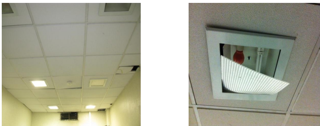
Figura 2.12 Luminarias de la sala de rayos X.
