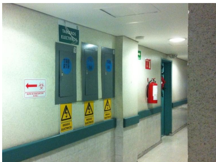
Figura 2.13 Tableros eléctricos del área de radiodiagnóstico.
