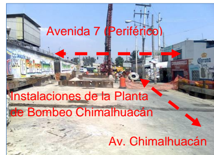
Foto 11.5.2.5 Vista sobre la Av. Chimalhuacán y la calle 1, al fondo a la izquierda se encuentran las Instalaciones de la Planta de Bombeo Chimalhuacán.
