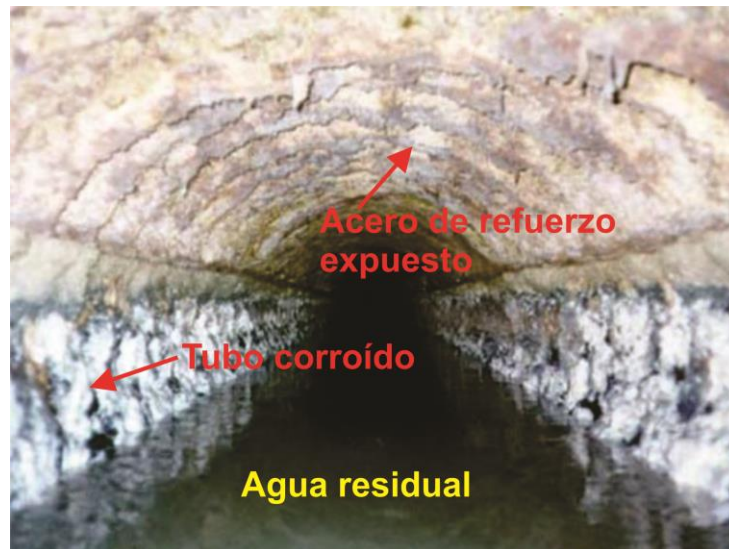
Figura 2.2 Tubería de concreto corroída con el acero de refuerzo expuesto
