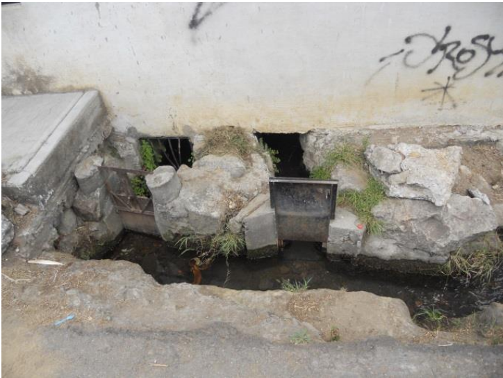
Fotografía 17. Sistema de control y distribución por medio de compuertas.
