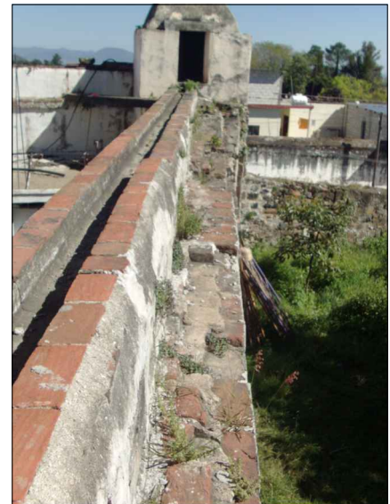
Fotografía que muestra la caja repartidora 2, en donde se aprecia el acueducto 2, el cual se encargó de recibir el agua distribuida de dicha caja.
