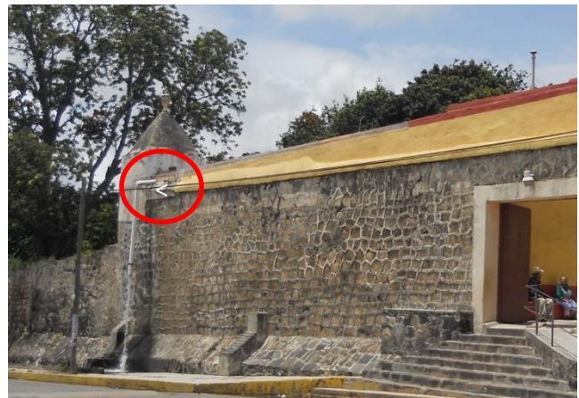
Fotografía 15. Canal por barda. Nótese la adaptación que se realizó para dirigir el agua por la tubería de pvc e impedir su dirección hacia la caja repartidora 2.
