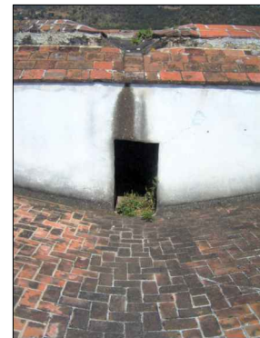
SISTEMA DE CAPTACIÓN DE AGUA PLUVIAL EN LA CUBIERTA DEL TEMPLO.
