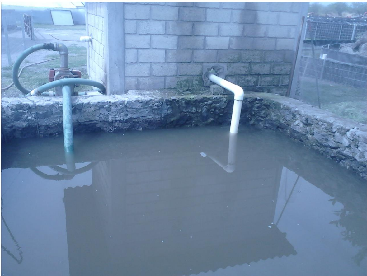
Figura 8, Estanque de almacenamiento de agua
