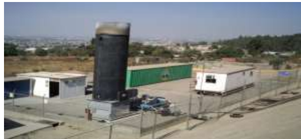
Quemador de biogás
