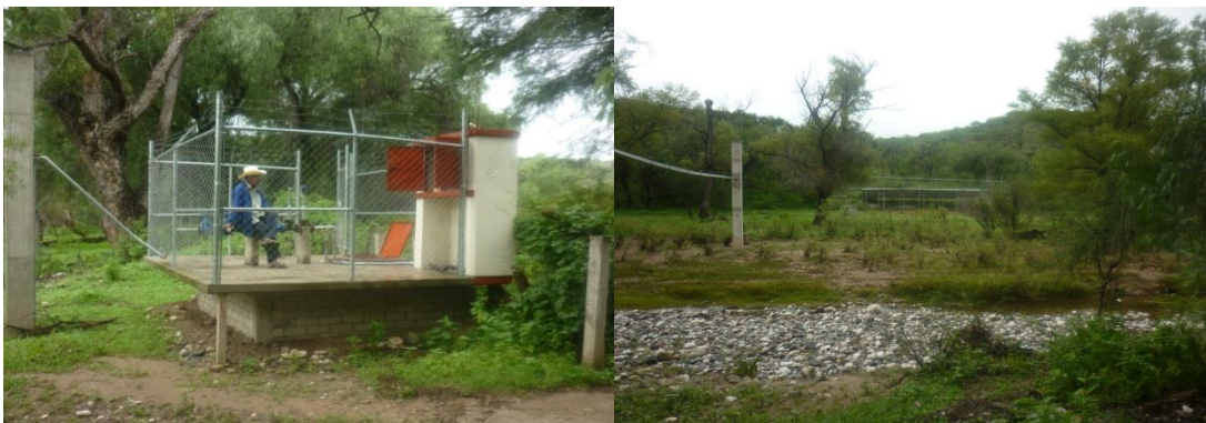
Figura 28. Pozo del agua con los paneles solares.
