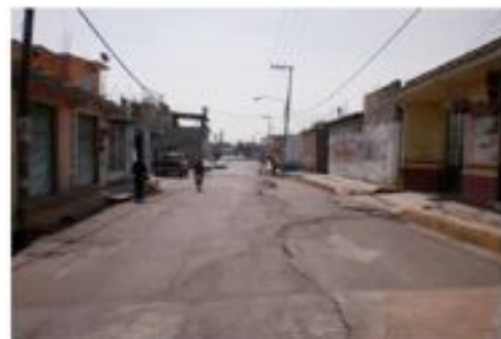
Img. 29 Vista de una calle agrietada del pueblo.
