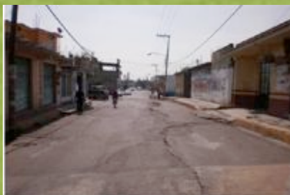
Img. 21 Asfalto levantado por fractura del suelo en calle de Mixquic.
