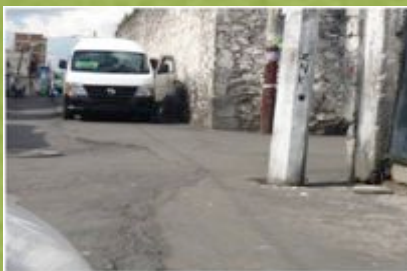
Img. 20 Fractura del suelo en calle de Mixquic.
