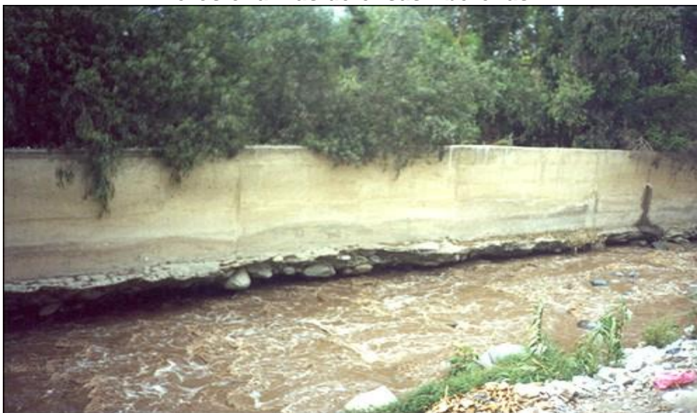
Figura 20: Se incrementan las amenazas por crecida del caudal del río y se erosionan las defensas ribereñas
