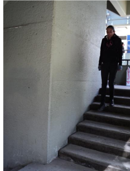
El cuerpo central del módulo de servicios sirve de apoyo a las escaleras y aloja instalaciones eléctricas
