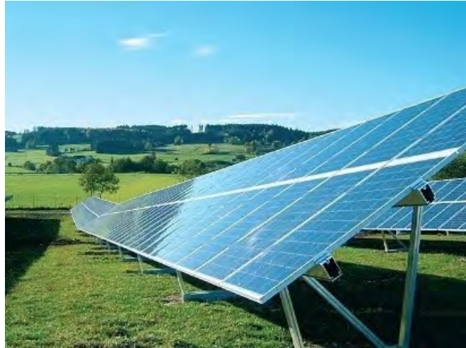
Figura 3.3: Panel fotovoltaico, conformado por módulos fotovoltaicos .
