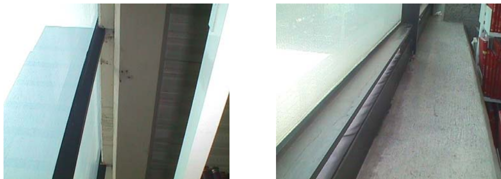
Figura. 7 Filtraciones en la biblioteca de la Facultad de Ciencias, UNAM.
