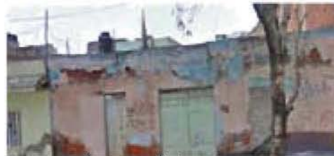
E. Zapata, entre Progreso y calle 3 Casas habitación de un nivel con fachadas desgastadas
