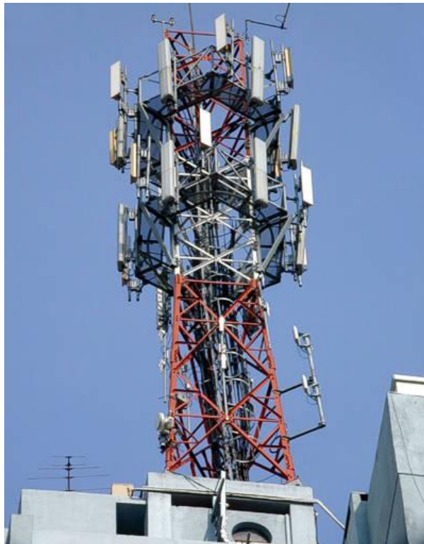
Figura 3.4 Torre con diversas antenas
