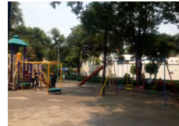
4- Pavimento en mal estado
