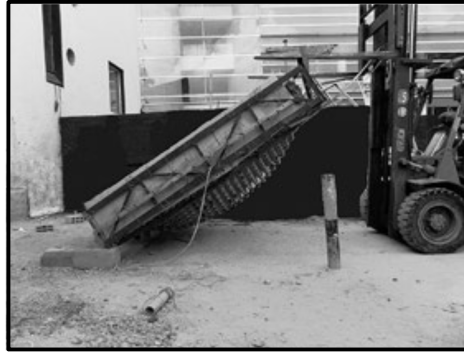
Figura III.16. Estado del muro con inclinación.
