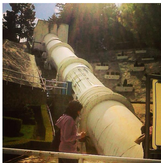
Imagen 2.11. Ramal de alta presión entre la Planta potabilizadora y la Planta de bombeo No. 5
